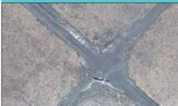
Пример разрушения в стыках
