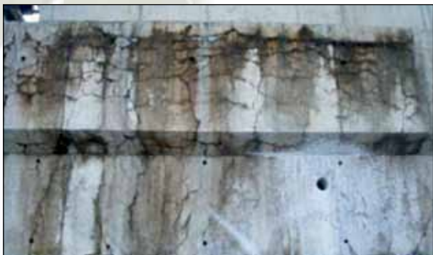
Разрушения из-за реакции взаимодействия щелочей цемента с заполнителями бетона
