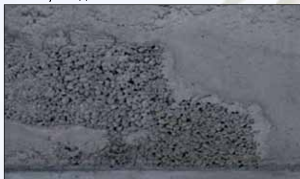
Разделение заполнителей в бетоне
