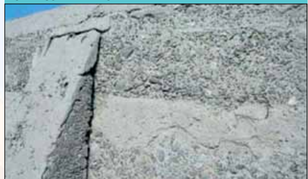
Влияние поверхности бетона выщелачивания
