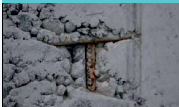
Открытые арматурные стержни в бетоне
