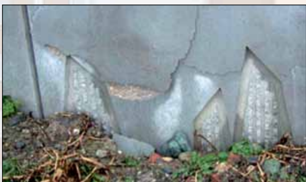
Разрушение, вызванное циклами замораживания/оттаивания
