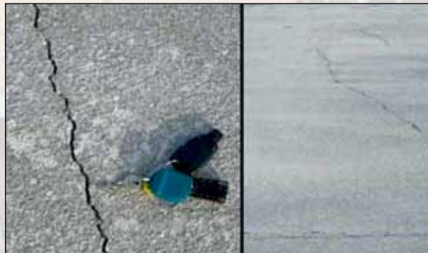
Разрушение в результате замерзания
