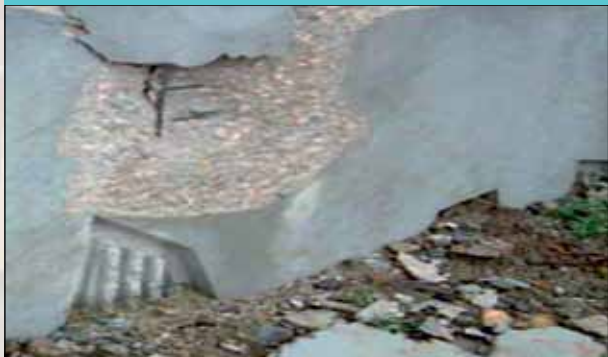
Разрушение в результате замерзания
